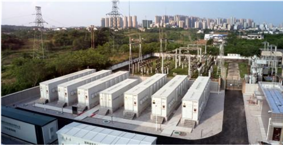
湖南电网邵阳磨石高压级联型储能电站
